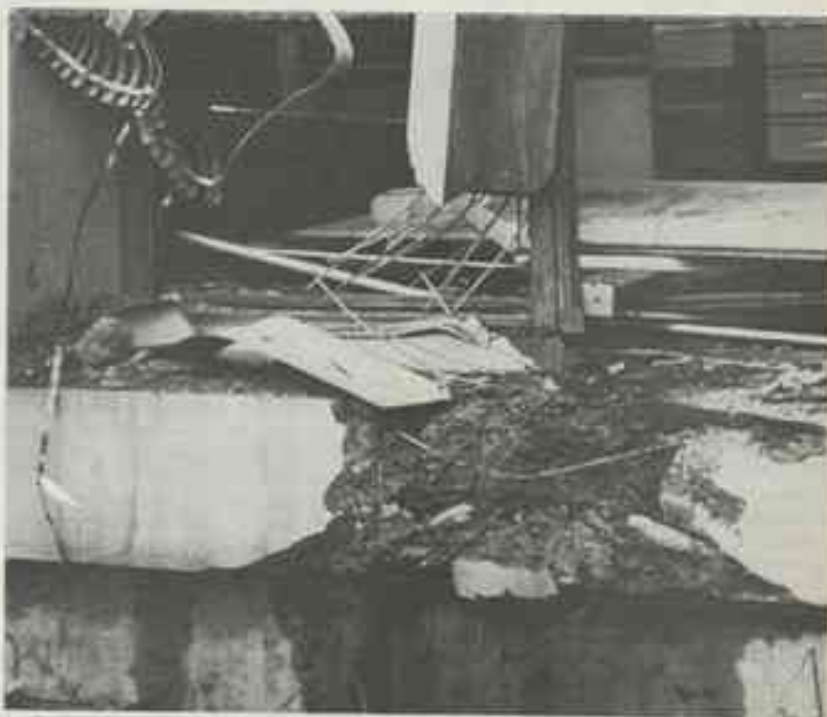
Un pilier de béton du bâtiment abritant l'équipe, a été défoncé. L'endroit creux est celui où a été posée la charge explosive (ERA 598).
