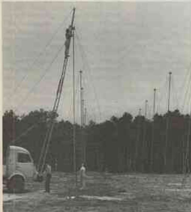
Fig. 5 - Montage d'une antenne. Approchée sur une flèche au-dessus d'un camion, elle est transportée du gabarit à sa position définitive dans le réseau.
