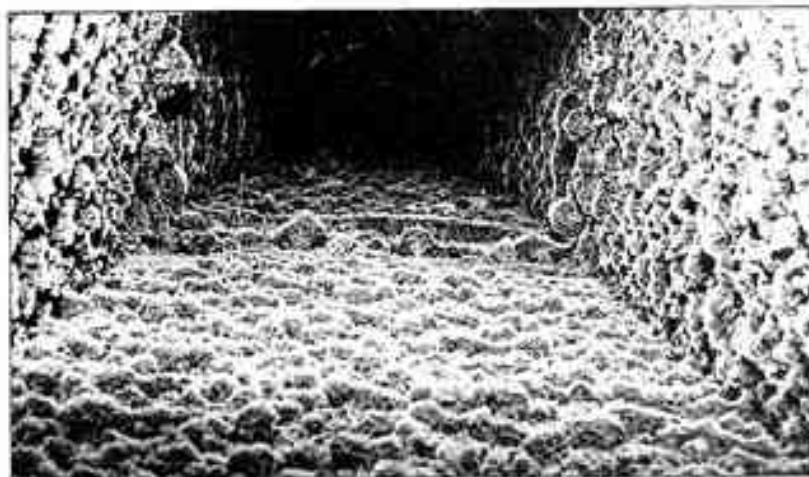
Gaine de climatisation colmatée. (© CAMFIL, cliché M. Rault).
