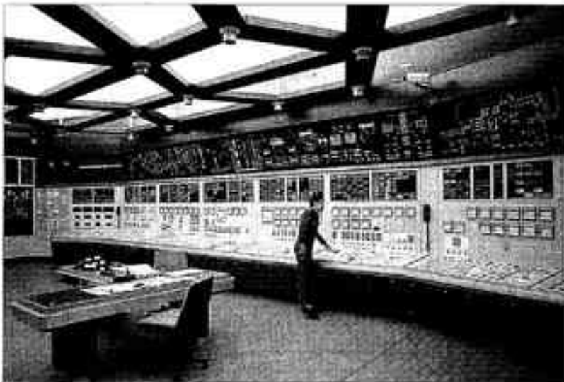
■ Salle de commande de la centrale nucléaire de Chinon. (Sodel, photothèque EDF, cliché J.-F. Le Couquer). L'omniprésence de l'informatique dans le développement technologique rend chaque jour plus nécessaire le développement d'outils de programmation fiables. Les recherches en sémantique trouvent là leur principale motivation.
