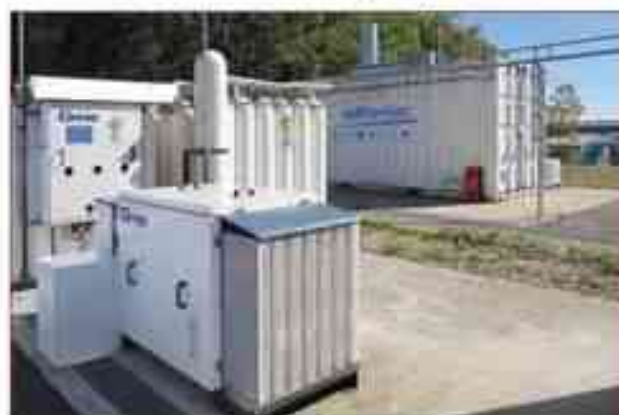
Photo 2. Station de production de biométhane carburant avec, en second plan, le pilote de production d'hydrogène (Photo N. Pallou).
