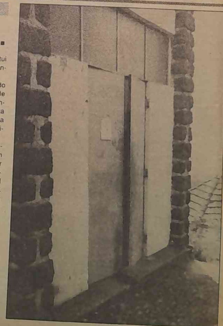
Como se pode ver pela foto, as portas do posto de alta tensão
