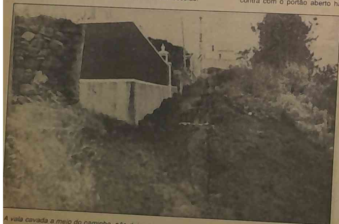
A vala cavada a meio do caminho, não deixa mesmo hipóteses aos transeuntes. A «obra» já dura há que tempos.
